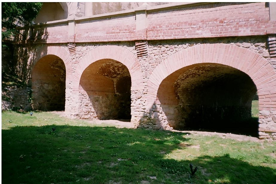
Fot. 7. Sklepienia barokowego mostu na Wzgórzu Zamkowym w Nitrze są tak samo zasolone i zawilgocone, jak przed jego zburzeniem (fot. Marta Žilková)
