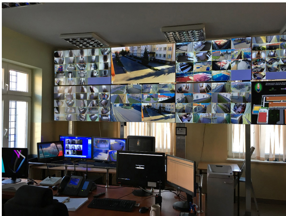
Fot. 1. Typowe pomieszczenie monitoringu (Białystok), kwiecień 2019 (fot. D. Niedźwiedzki)
