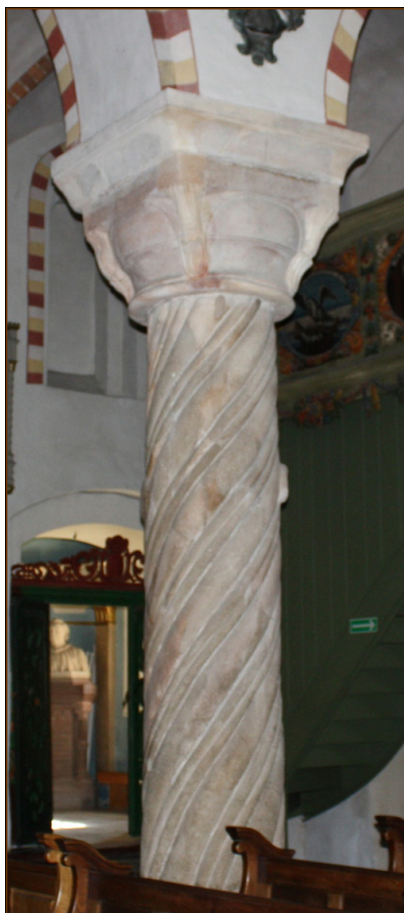
Ryc. 9. Strzelno, bazylika Świętej Trójcy – korpus nawowy. Romańska kolumna południowo-zachodnia. Warstwa malarska widoczna na trzonie i głowicy. U góry i w głębi trójkolorowa polichromia – rekonstrukcja malarska po pracach konserwatorskich. Fot. J. Struwe
